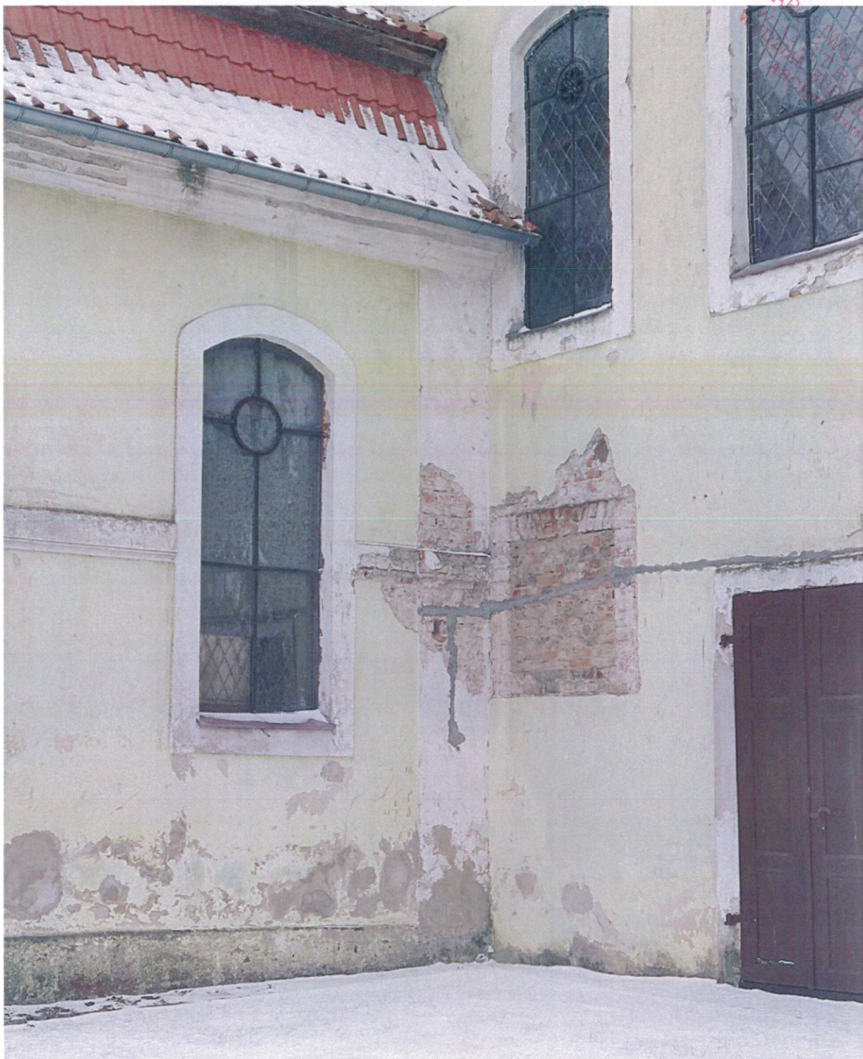
Zdjęcie 14. Zbliżenie na elewację zachodnią zakrystii. Widoczny zбитy tynk na zamurowanym oknie dolnego poziomu.
