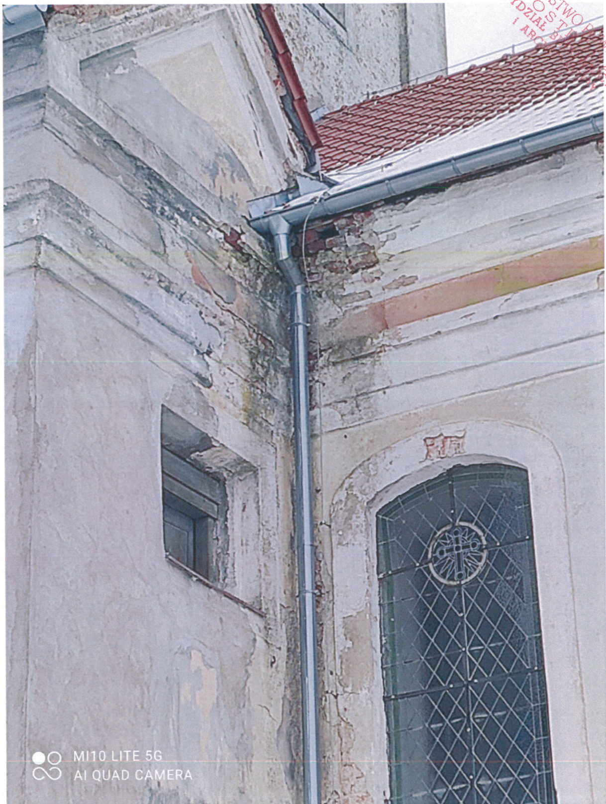
Zdjęcie 7. Zbliżenie na miejsce styku dachu nawy głównej z dachem wieży schodowej południowej
