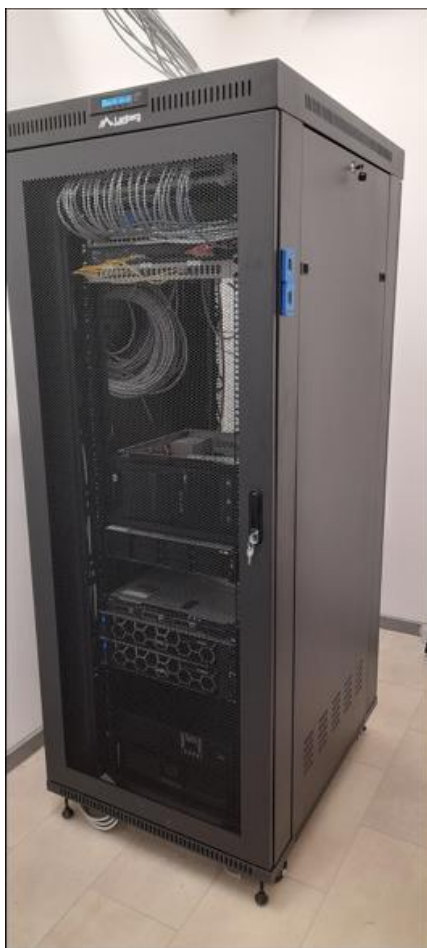
*szafa Rack oraz dwa nowe serwery
